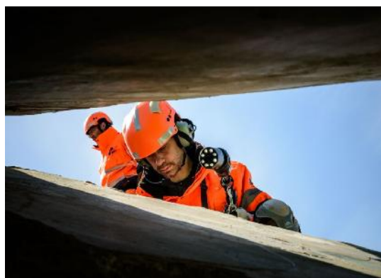
Зураг 2. Барилга байгууламжийн нурангины хаалттай хийц бүтэц, том хавтан хэлбэрээрээ нурсан хэсэгт үзлэг шалгалт хийх нь.
